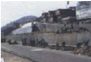
Construcción del muro de contención de la Av. Tahuaytinsuyo y Sacsayhuamán, en convenio con el programa "A Trabajar Urbano".
